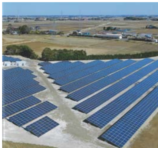
茨城県霞ヶ浦流域下水道事務所 利根浄化センターの太陽光発電設備
