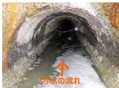
老朽化した下水道管
